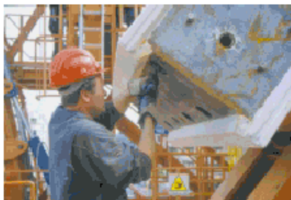
Pulitura dei fori delle guaine prima del montaggio Cleaning of the sheath holes before block assembling
